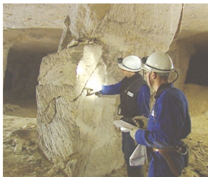
Constat d'une dégradation en cavité souterraine.
